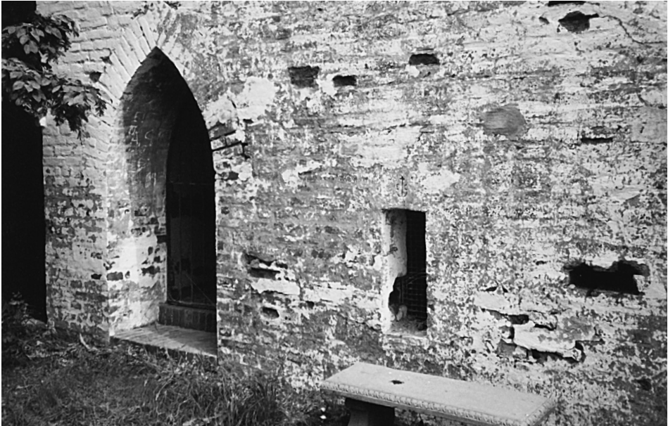
Abb. 5: Zustand der Westfassade mit Zugang zur Gruft.
