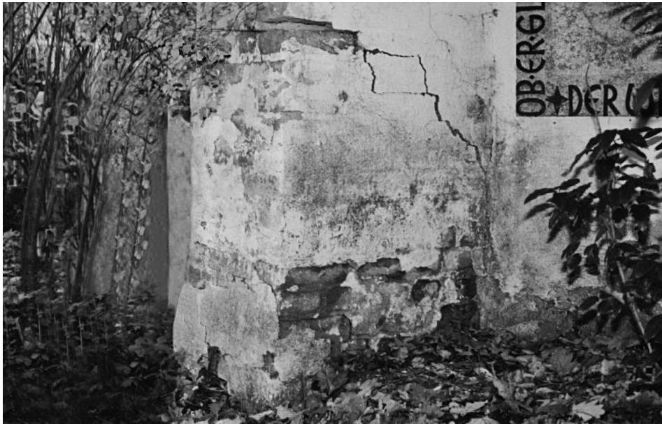
Abb. 4: Gefährdetes Mauerwerk an den Südweststützen infolge Durchnässung und Auslaugung der Mauerwerksfugen.
